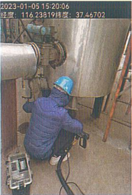
灌装过程尾气管线(送碳一硫回收)
