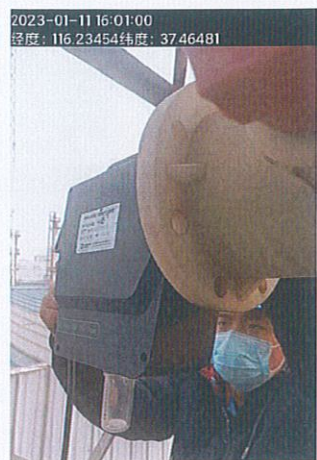
DA063 醋酐重组分焚烧炉
