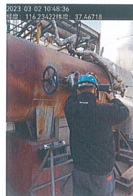
DA119 碳一硫回收放空筒出口
