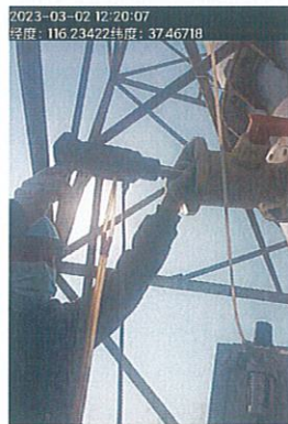
DA063 醋酐焦油焚烧炉放空塔
