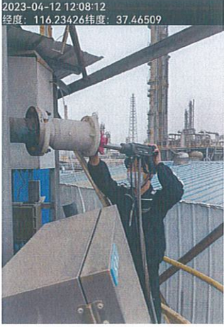
DA063 醋酐焦油焚烧炉放空塔
