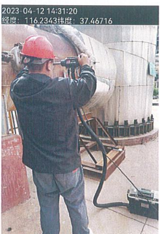
DA119 碳一硫回收放空筒出口
