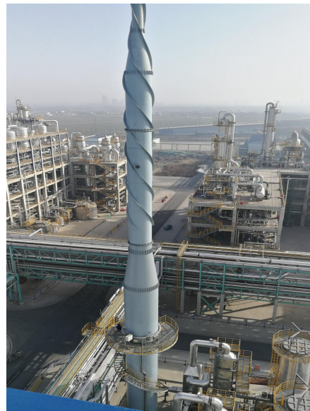
项目导热油炉排气筒 (P5)
